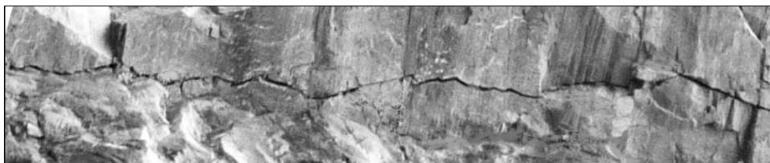
Рисунок 8. Поверхность ослабления (трещина):
