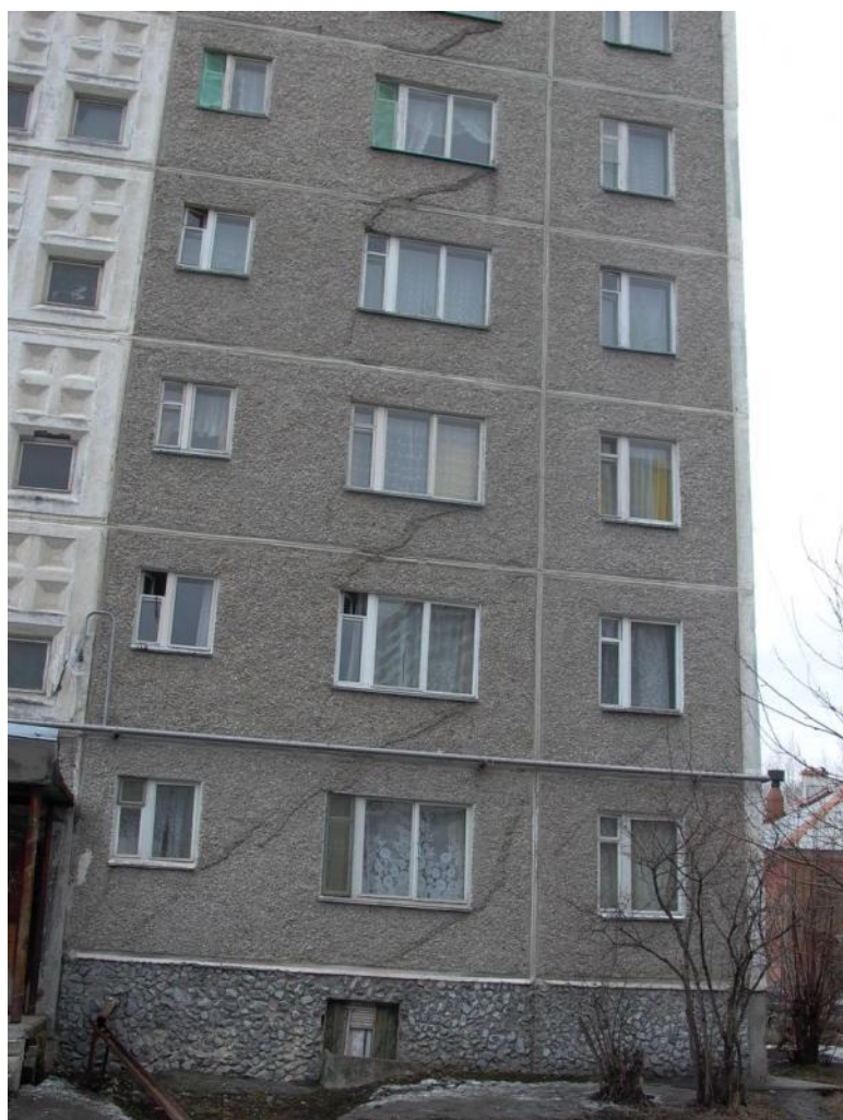
Рисунок 1.2 – Деформация в жилом доме в Екатеринбурге
