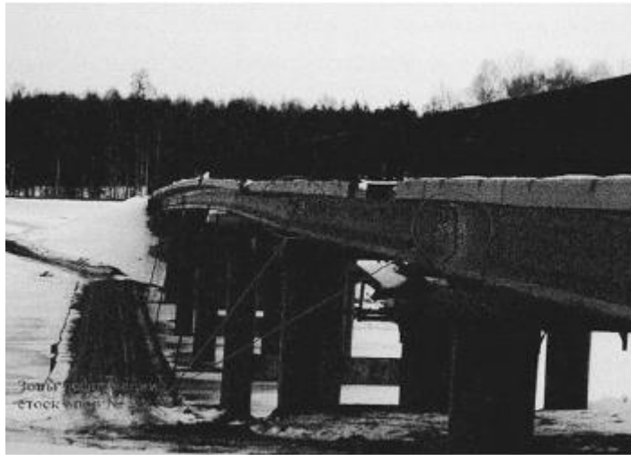
Рисунок 2.7 – Деформации моста через реку Сосьва
