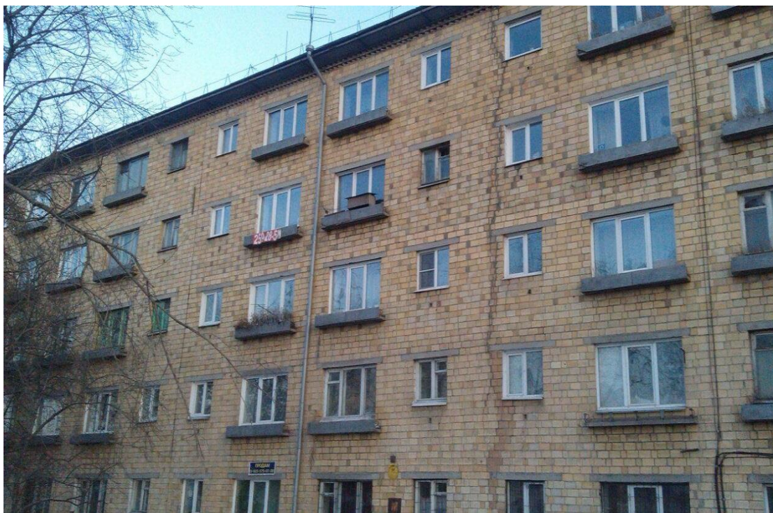
Рисунок 1.1 – Деформация в жилом доме в Красноярске
